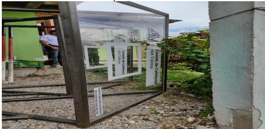
Foto 3. descripción: 2 tableros sin Instalar
